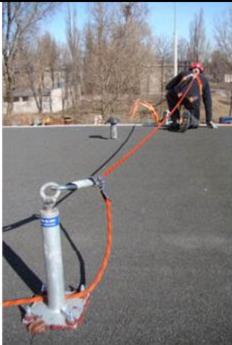
Rys. 1 Stały punkt kotwiczenia z linką o długości uniemożliwiającej dotarcie pracownika do miejsca grożącego upadkiem z dachu.
